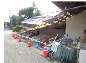
倒壊した倉庫
