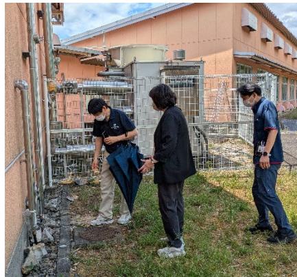
犬走り※の陥没(くすのき園) ※外壁沿いの細い舗装部分
