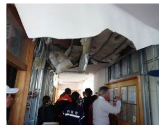
壁紙等が落下した天井部分
