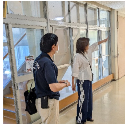
建物の亀裂(くまむた荘)
